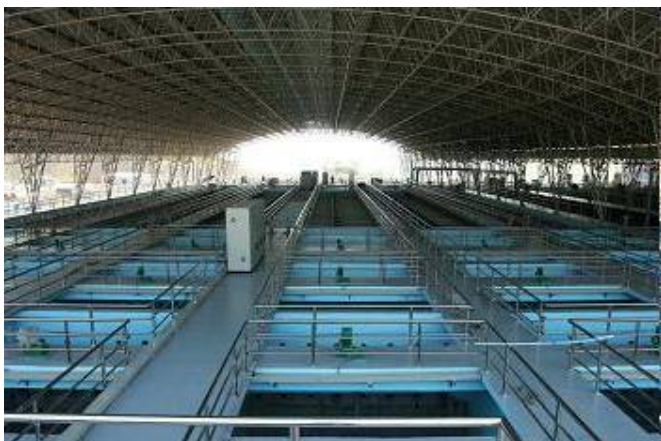
b) Khu xử lý nước (bể trộn - keo tụ - lắng - lọc)
