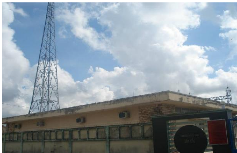
Hình 23: Trạm Biến Áp Bến Cầu
